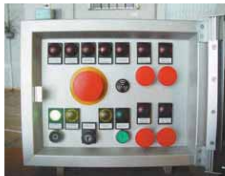
Пульт аварийного останова
