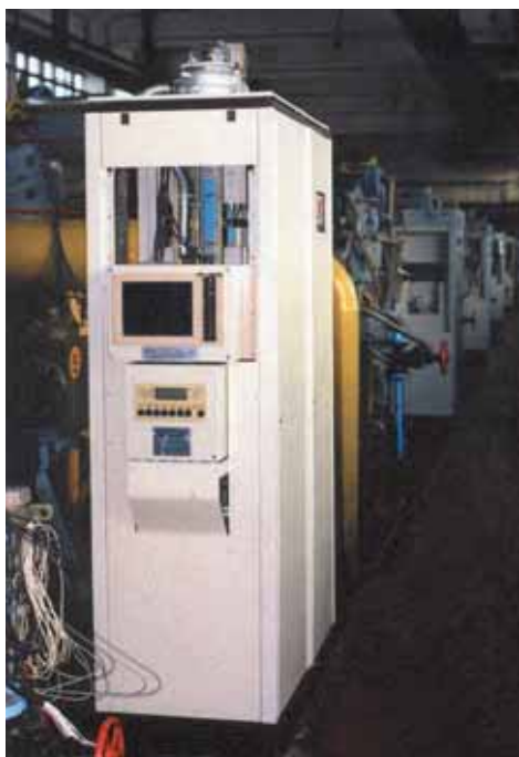
БУ в составе САУ ГМК на Канчуринской СПХГ, Баштрансгаз
